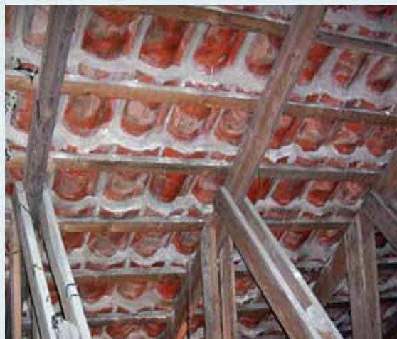
Er der utætheder i understrygningen, skal de repareres snarest.
