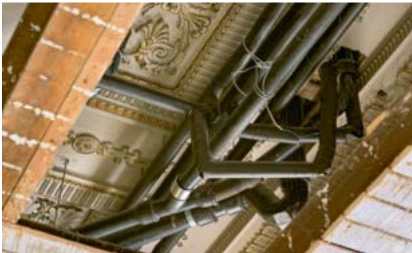
Oppe under et træloft fandt arkitekterne - bag faldstammerne - det oprindelige, smukke loft.
