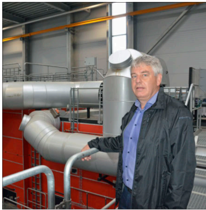
Det er ikke mindst opførelsen af det nye flisvarmeværk, som direktør Søren Gertsen her står i, der har gjort det muligt at sænke varmeprisen i Grenaa. Foto: Søren Andersen
